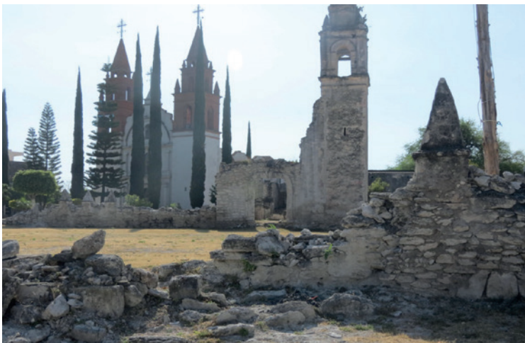
Imagen 13. Sismo Santa María Coacucán 2017, templo nuevo y Capilla antigua. Foto propia.
