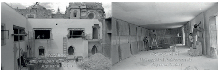
Imágenes 99 y 100. Remodelación de la planta alta para la Sala de Consejo Universitario. Fuente: Fototeca UAA.
