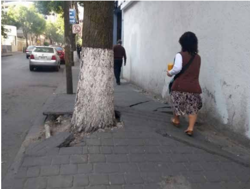
Imagen 78. Banquetas en mal estado
