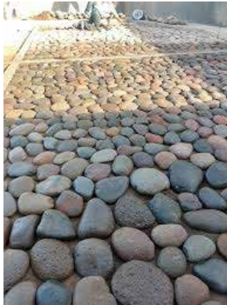
Imagen 46. Piso de piedra bola, totalmente inadecuado
