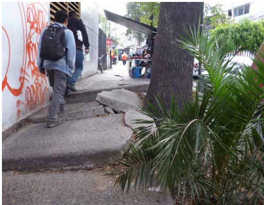
Imagen 6. Ejemplo de acera en mal estado
