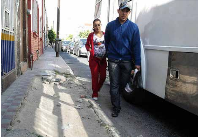
Imagen 7. Ejemplo de acera en mal estado
